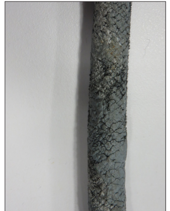
• Rastro de producto químico
