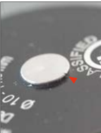
• Remache ligeramente fisurado
